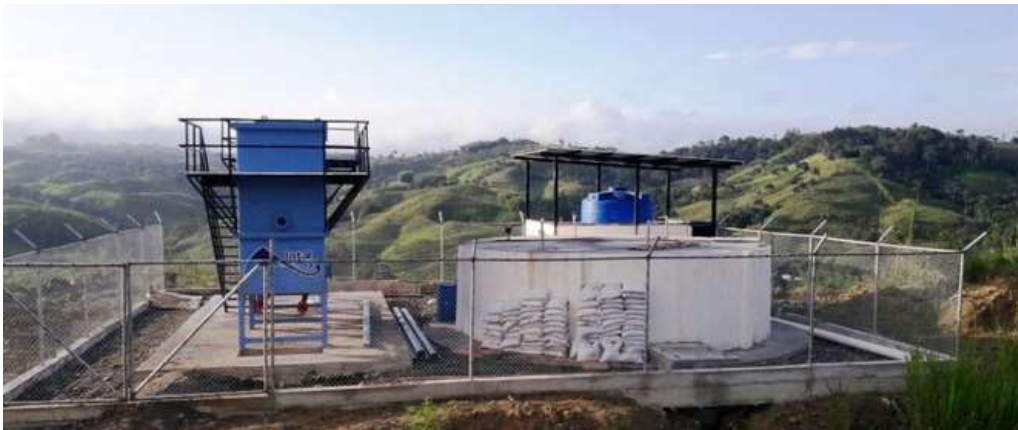
Imagen N° 40 Planta Potabilizadora Modular Compacta De Agua Elaborado por: GUADAMUD&GILER CONSULTCONFIANZA S.A
